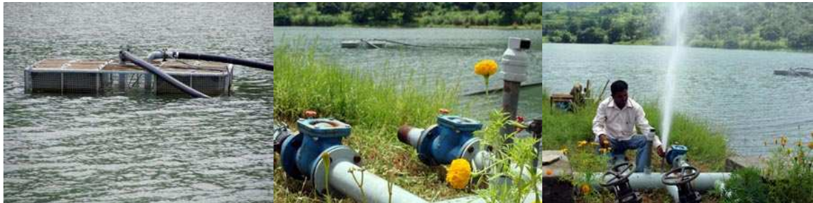
カタルカダック村の灌漑設備 写真（左）水に浮かべたモーターで水を汲み上げる 写真（中央）配水管を通して水が農地へ供給される 写真（右）配水管の水圧をテストするタナジさん（写真提供：OWSA）
